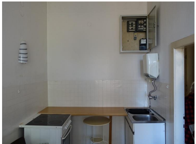
Abbildung: Küchennische, Sicherungskasten
